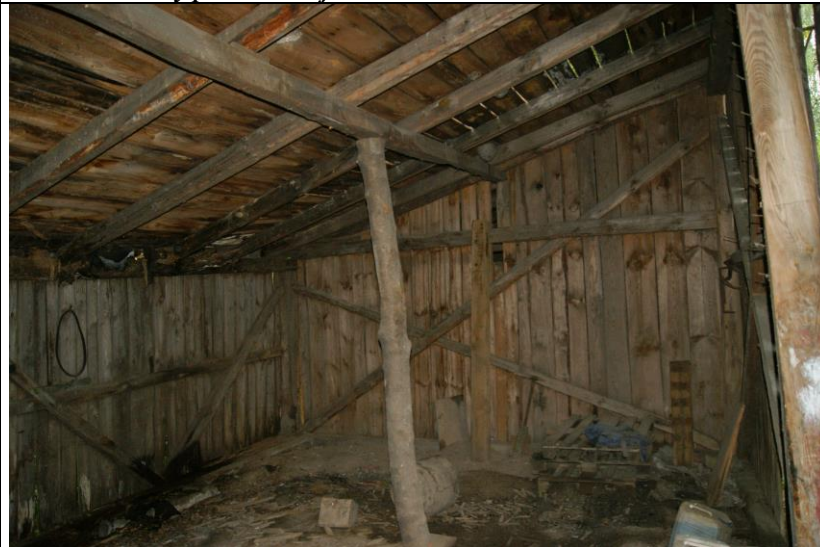
Uszkodzenia podwalin, dachu, słup prowizoryczny pom nr 1
