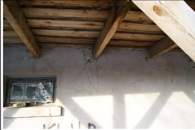
Spękania muru – ściana wschodnia
