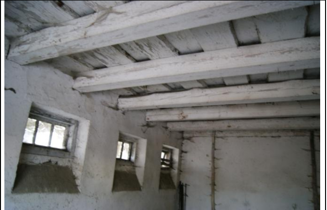
Stan stropu spękania muru pod belkami – ściana północna
