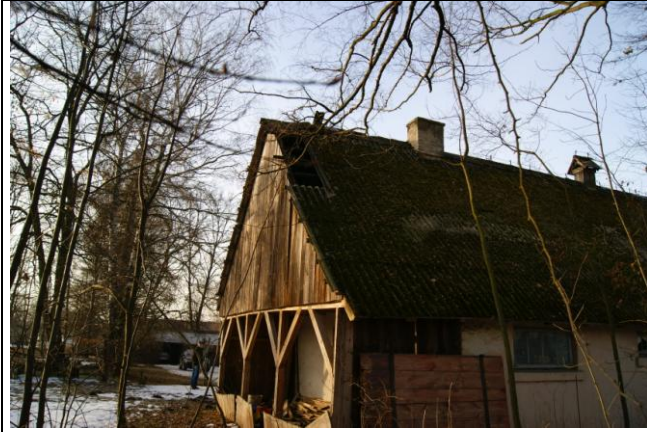
Uszkodzenia pokrycia dachowego
